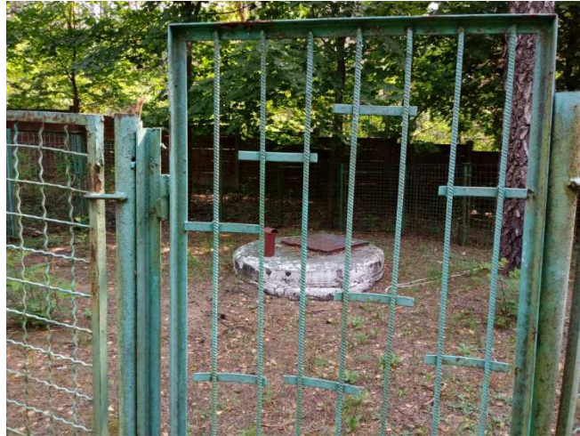
Widok studni głębinowej nr 6
